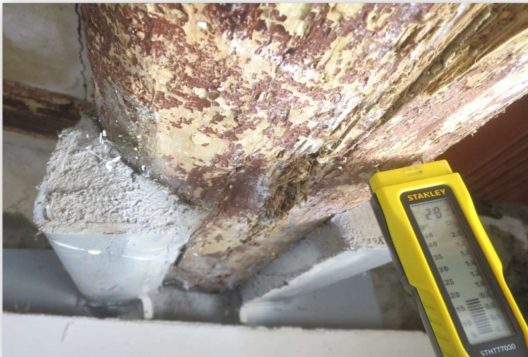
Sostre de la planta segona (P2), porta 2 (P2). Element P2P2A1. Imatge 053 Element reforçat en l'extrem nord-est, l= 30 cm Humitat de la fusta 17 %
