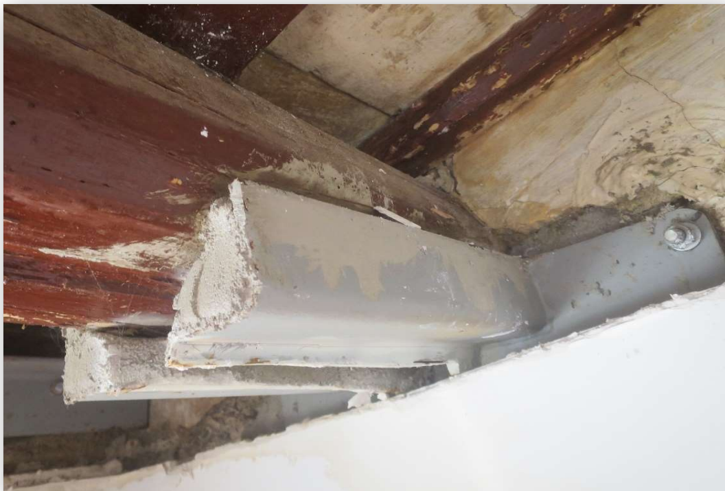
Sostre de la planta segona (P2), porta 1 (P1). Element P2P1A1. Imatge 039 Degradació lleu causada per corcs i fongs de podriment Element reforçat en l'extrem sud-oest, l= 30 cm
