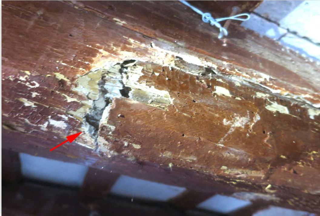
Sostre de la planta segona (P2), porta 1 (P1). Element P2P1A9. Imatge 045 Trencament de les fibres
