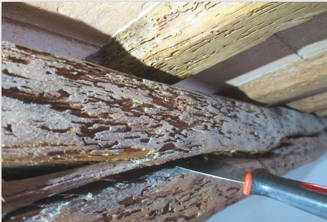
Sostre de la planta segona (P2), porta 1 (P1). Element P2P1A16. Imatge 041 Clivelles significatives horitzontals ( \geq 2/3 de la llargada)
