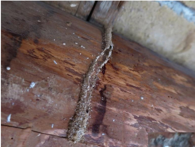
Canal de tránsito de termitas subterráneas
