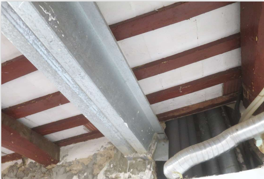
Sostre de la planta segona (P2), porta 2 (P2). Element P2P2A14. Imatge 051 Element reforçat totalment (sistema Noubau)
