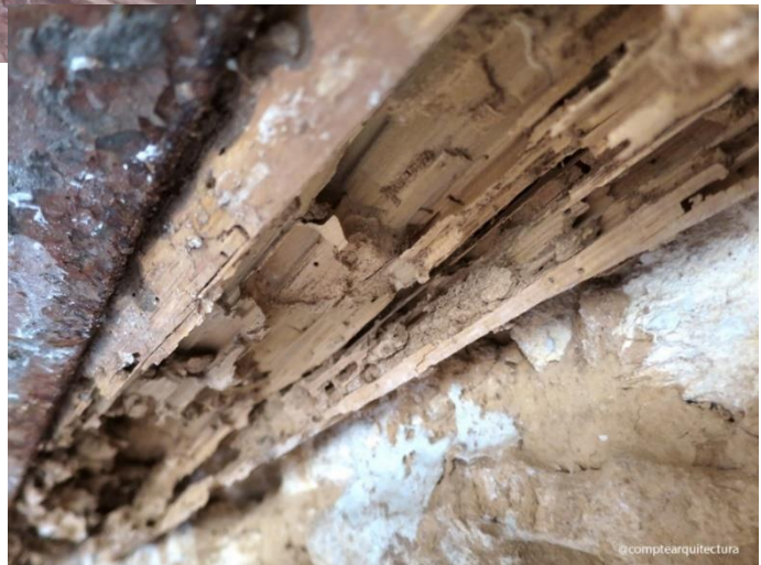
Degradación de la madera causada por termitas subterráneas
