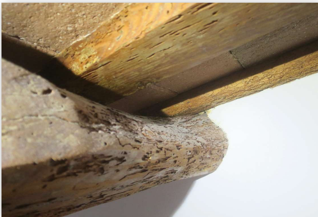
Sostre de la planta segona (P2), porta 1 (P1). Element P2P1A16. Imatge 048 Reducció significativa de la secció en l'extrem nord-est
