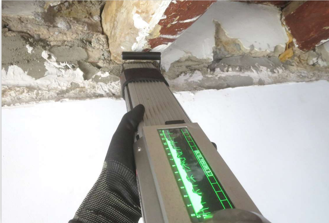
Sostre de la planta segona (P2), porta 2 (P2). Element P2P2A3. Imatge 057 Degradació causada per corcs i fongs de podriment Comprovació de la secció amb el resistògraf
